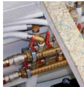
Aufwändige Hydraulikinstallation für Bug- und Heckschraube bzw. das Ankerschirr.
