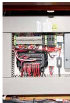
Bei so viel Technik muss die Elektronik-Installation gut sein.
