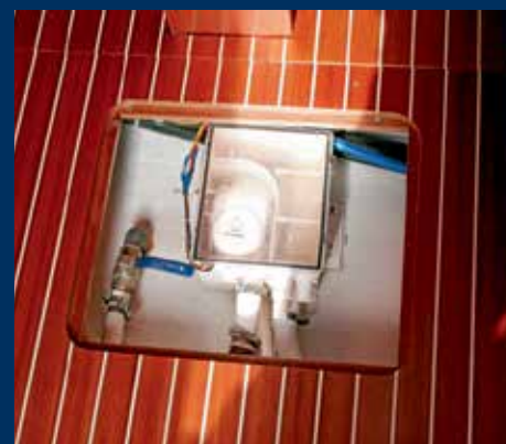
Tiefster Punkt im Boot: Im Bilgensumpf läuft das Abwasser zusammen und wird von dort aus in den Tank gepumpt.
