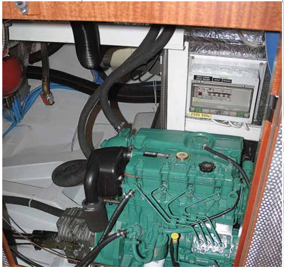
Oben: Die Maschine und andere technische Geräte und Aggregate sind in einem separaten und großzügigen Raum untergebracht. Die Wartung kann hier ohne „zusätzliche Ellbogen und Handgelenke“ durchgeführt werden. Alles ist frei zugänglich.
