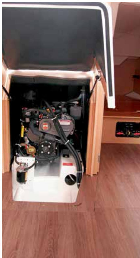
Wartungsfreundlich: An den Motor kommt man nicht nur von vorn, sondern auch durch seitliche Klappen in den Achterkabinen.
